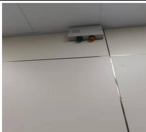
入口处机器工作状态指示灯
